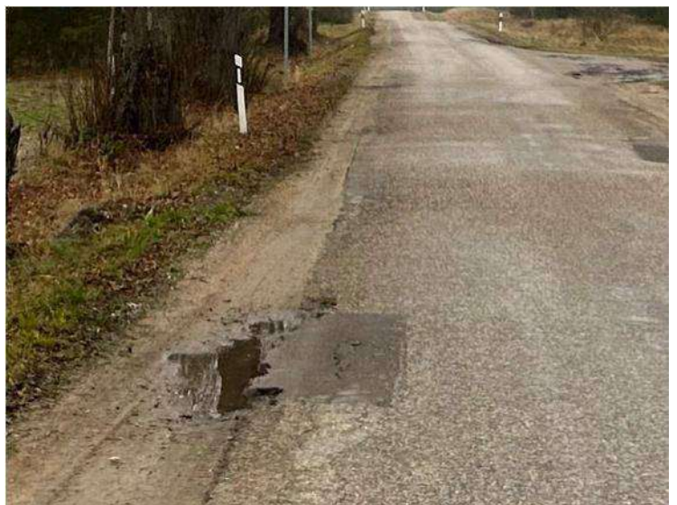
11 pav. Kelkraščių būklė
